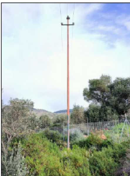
FOTO n. 18 palo M.T. 2 da rimuovere
