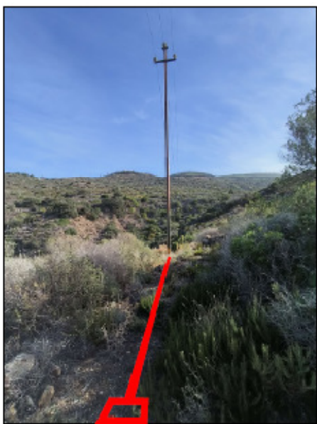
FOTO n. 17 palo M.T. 1 da sostituire
