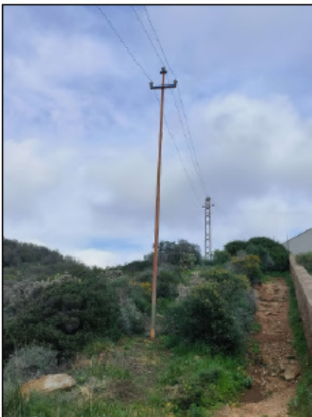
FOTO n. 21 palo M.T. 5 da rimuovere
