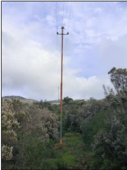
FOTO n. 19 palo M.T. 3 da rimuovere
