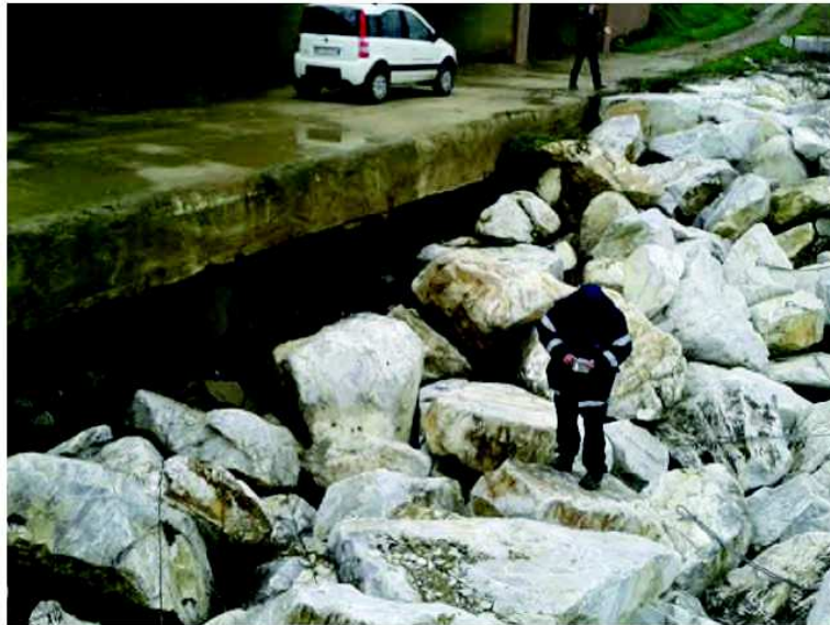
Fig. 4 Sprofondamento della scogliera
